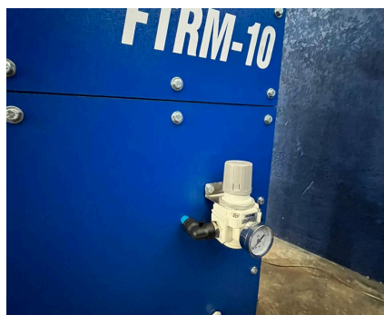
Regulador de ar comprimido com manômetro na entrada do manifold.
